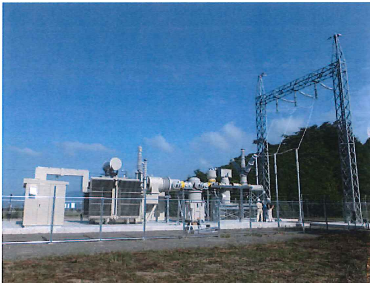
特高受変電設備
