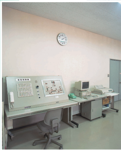
監視制御装置
