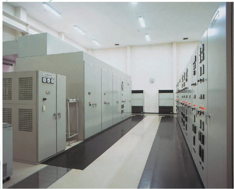
屋内電気室全景
