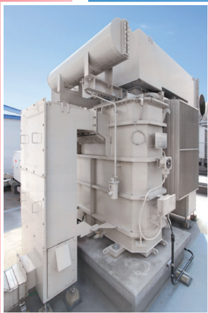
主変圧器 22kV 3MVA
