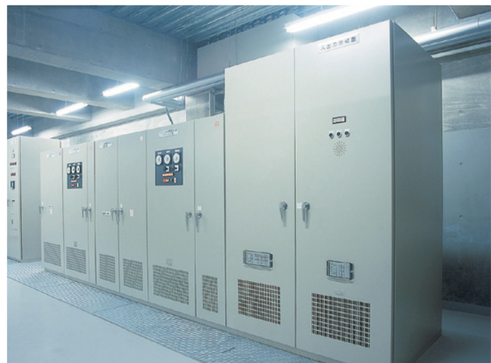
無停電電源装置・入出力分岐盤
