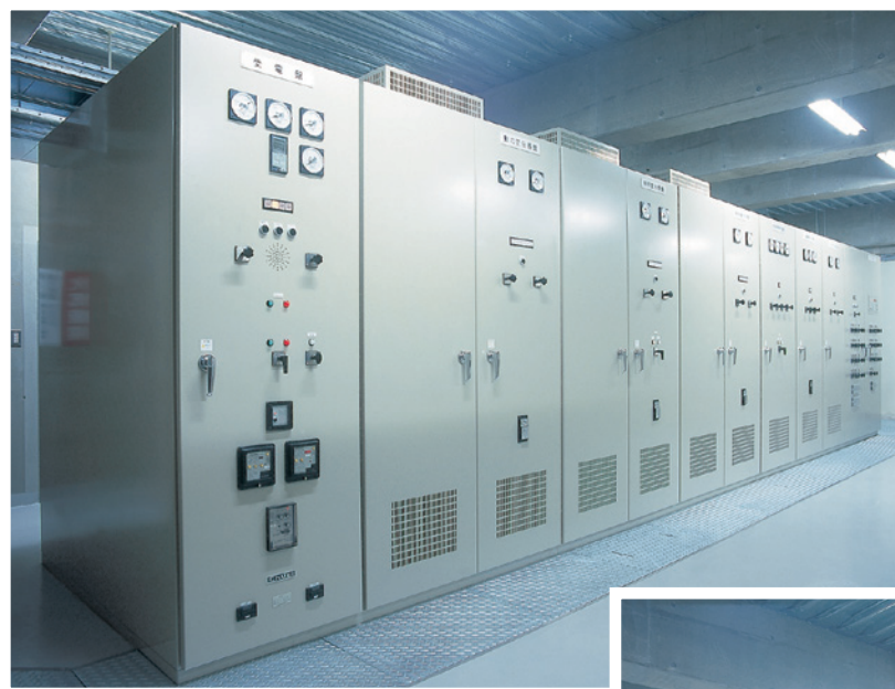
6kV受変電設備
