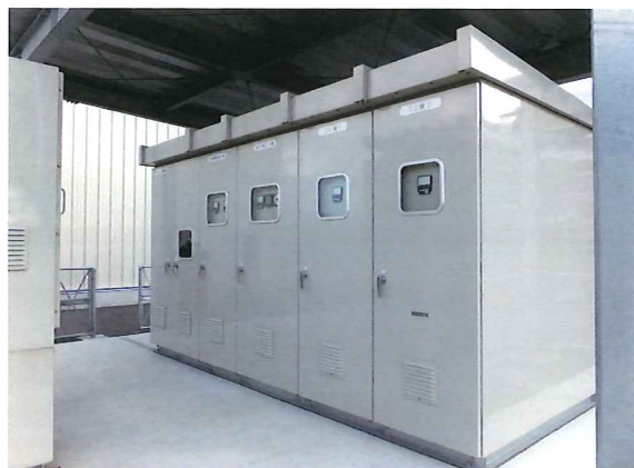
6kV変圧器二次盤・発電機連絡盤・SC盤
