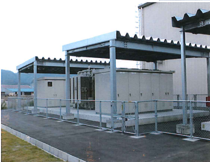
特高受変電設備
