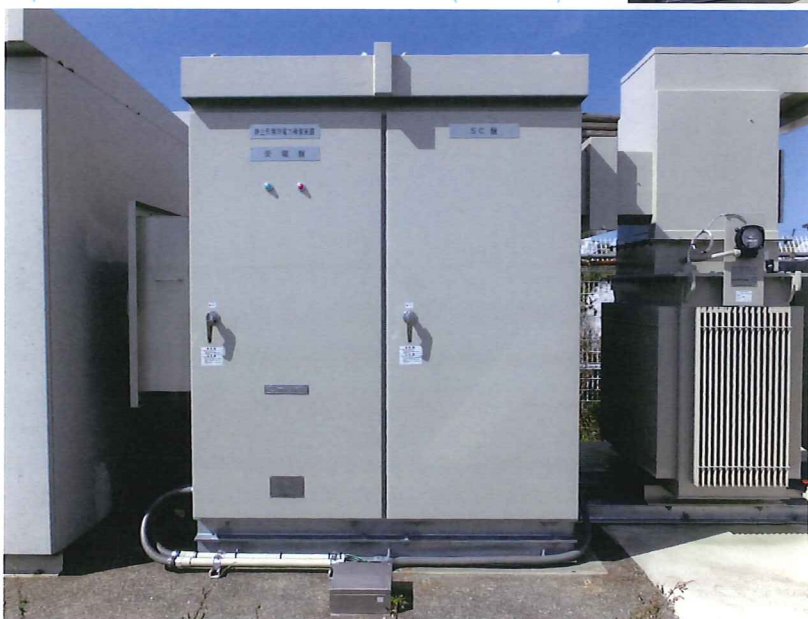
受電盤・SC盤
